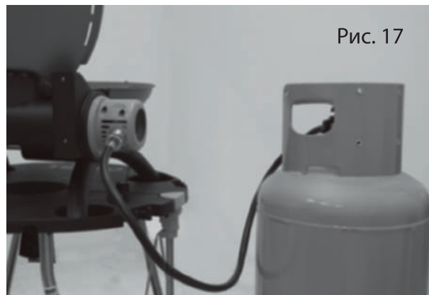
Подключение напольного газового баллона
